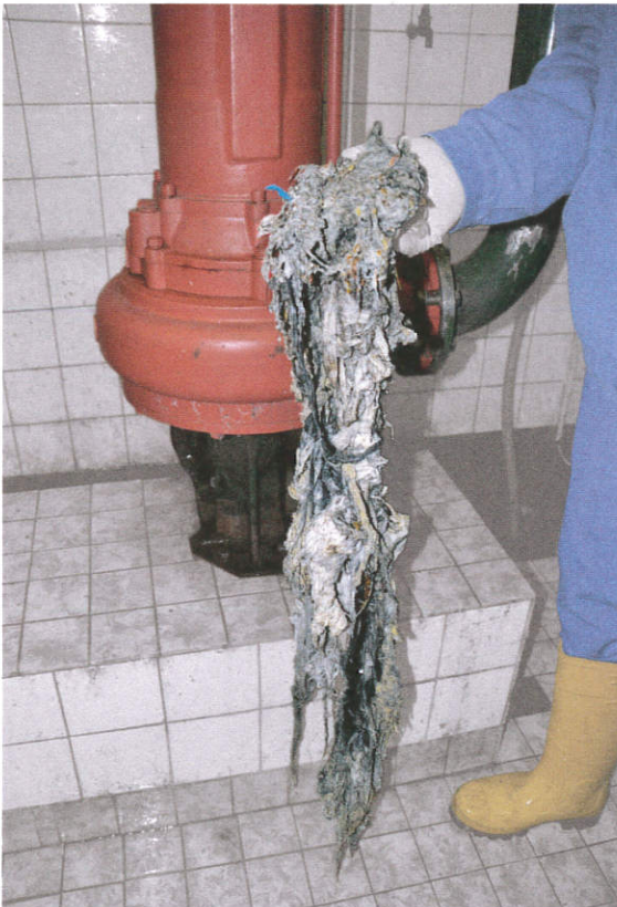
Sieht übel aus und ist es auch: verfilzte Feuchttücher. Regelmäßig legen sie Abwassersysteme lahm.
