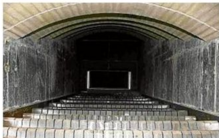
In der Brennkammer werden die Holz-hackschnitzel verfeuert. Momentan ist sie für Wartungsarbeiten außer Betrieb, ein Ölbrenner sorgt für das Heißwasser.
